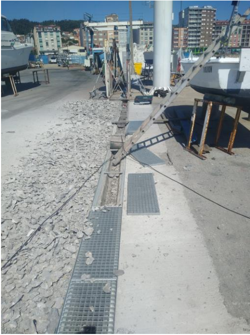
Ilustración 8. Instalación de rejilla en zona de varadero para asegurar correcta gestión de residuos generados en actividades de limpieza y mantenimiento de embarcaciones.
